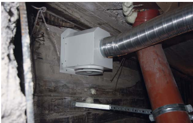
Alapohjaan asennettu VELCO APT-laitteisto tuo sinne korvausilmaa ja poistaa kosteaa ilmaa sekä radonia.
