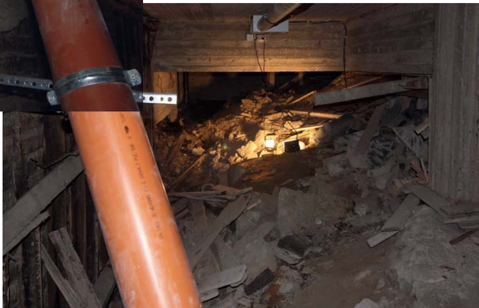
Alapohjan sisään oli jätetty valussa käytetyt laudoitukset.
